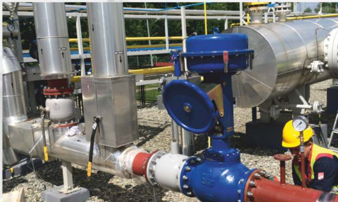
układ zaworowy-regulacyjny inst. gazu ziemnego
